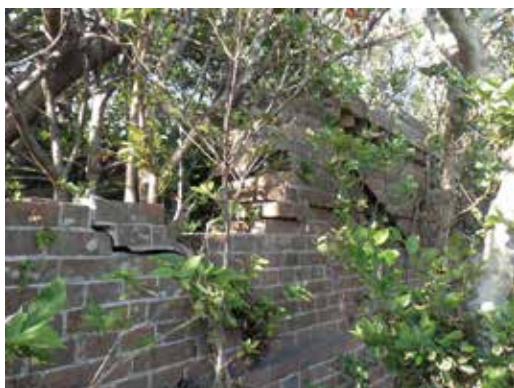
写真4 崩落しつつある煉瓦塀
